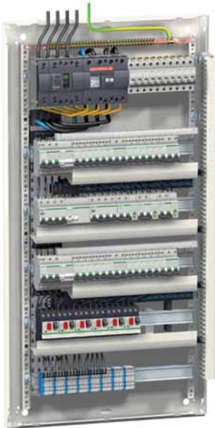
NG160 в модульном шкафу
